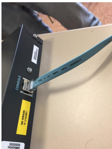
Figura 3.4.1 d: Boca consola del switch
