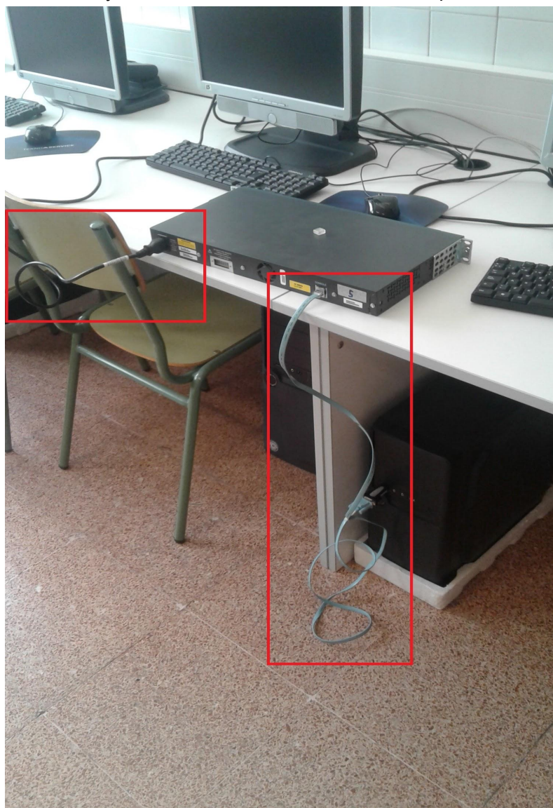
Figura 3.4.4.1. Conexión Switch Real al PC.
