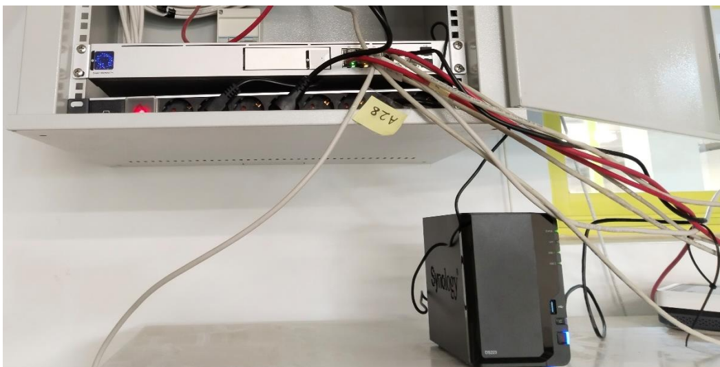
Ilustración 3 - Instalación NAS en infraestructura departamental
